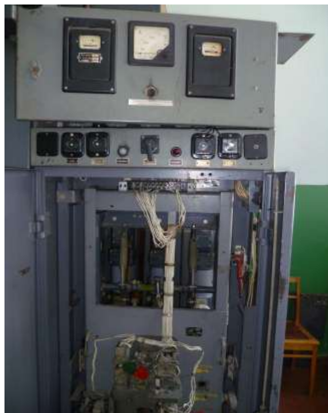
Рис.6. Зовнішній вигляд лабораторного стану №3.3 комплектна комірka зі встановленим малооб'ємним високовольтним вимикачем типу ВМП-6(10) кВ
