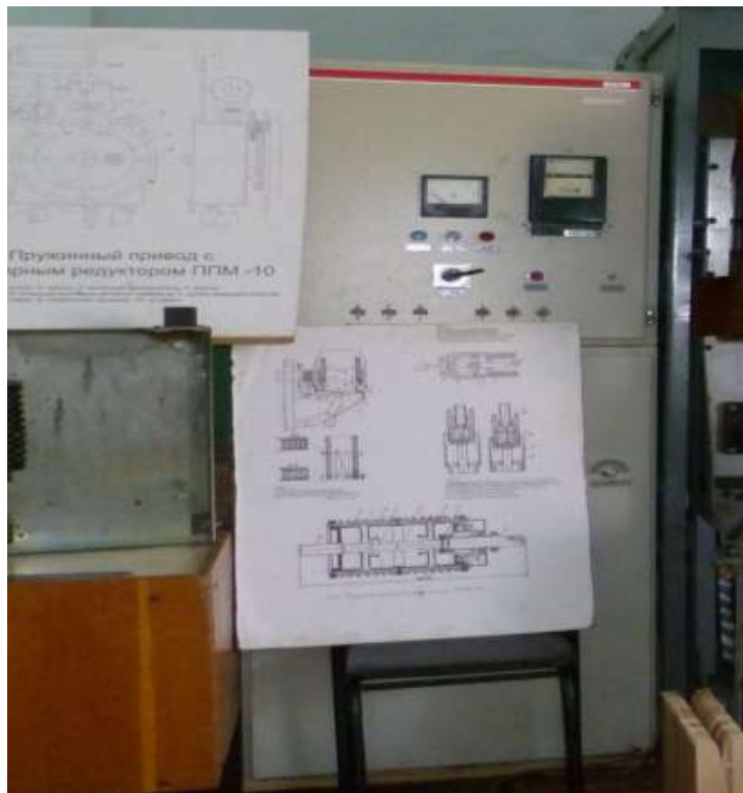
Рис.9. Зовнішній вигляд лабораторного стенду №5 з демонстративними матеріалами для вивчення конструкції дугогасної камери елегазових, вакуумних високовольтних вимикачів та демонстрації роботи комплектної комірки 10 кВ з вакуумним вимикачем серії ВР-10 кВ
