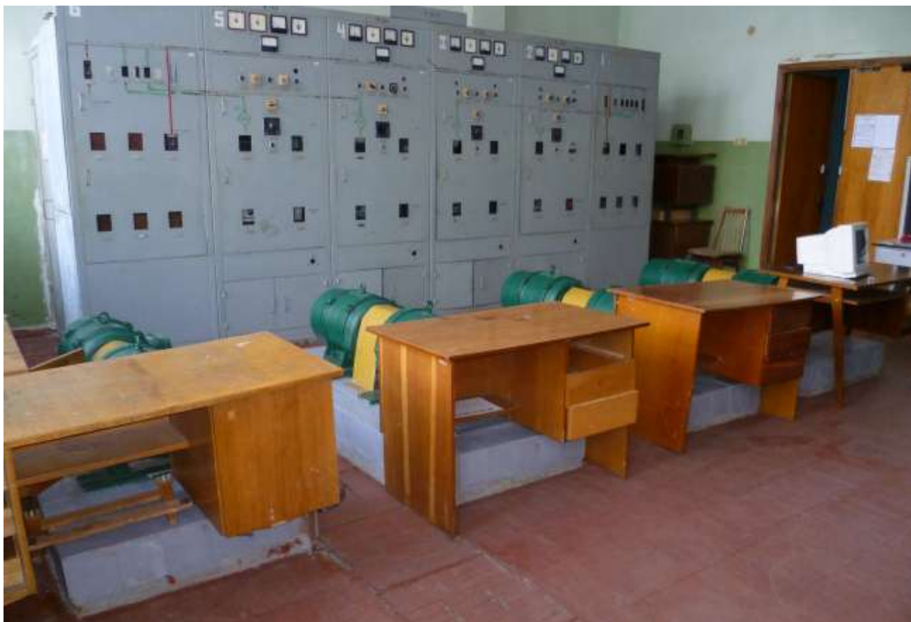
Рис.3. Зовнішній вигляд щита керування 2ЩУ
