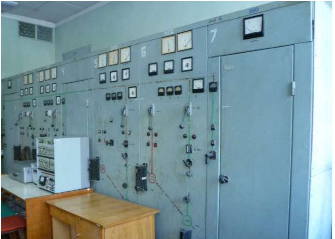
Рис.2. Зовнішній вигляд щита керування 1ЩУ
