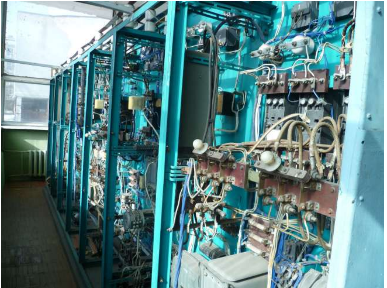
Рис.5. Зовнішній вигляд ланцюгів живлення, сигналізації та керування щитом 1ЩУ
