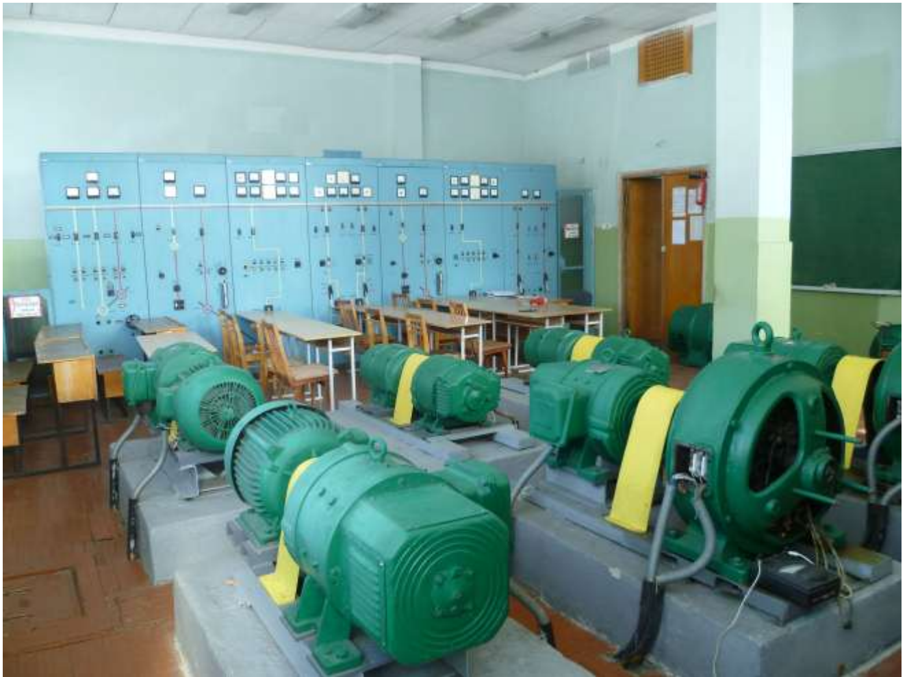
Рис.4. Зовнішній вигляд щита керування 2ЩУ з синхронними генераторами та двигунами постійного струму
