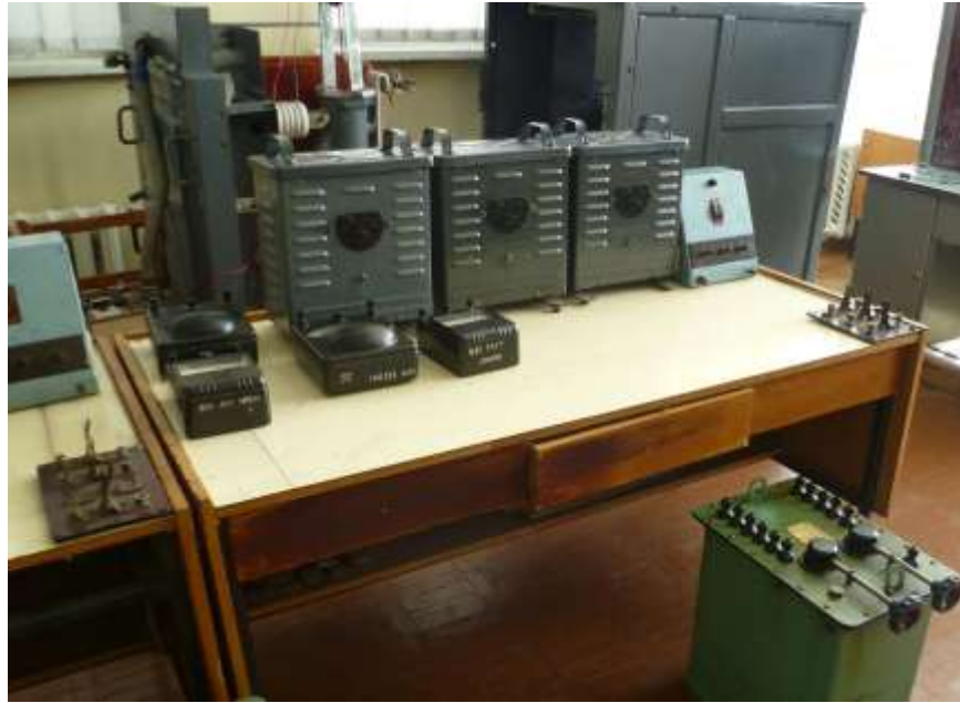
Рис.2. Зовнішній вигляд лабораторного стенду №2 для визначення реактивних опорів однофазних двообмоткових трансформаторів 220/37,5 В
